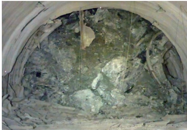
写真3 天端崩落発生状況
