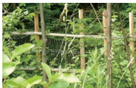
写真1 地元間伐材を活用した木製立入防止柵
