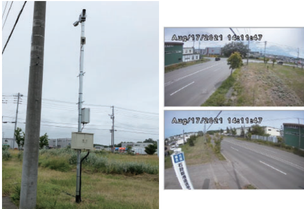
写真6 交通量の多い地点にはミリ波センサーとカメラを設置
