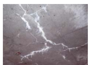
写真4 床版裏面の損傷状況
