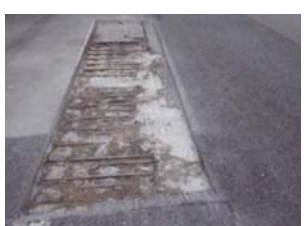
写真3 路面損傷状況
