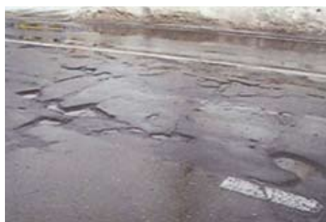
写真1 ポットホールができた舗装道路
