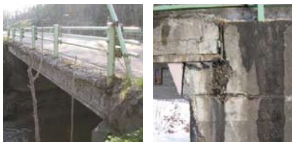
写真1 代表的な損傷例
