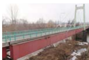
主桁の塗装劣化
