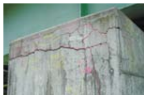
橋脚のひび割れ
