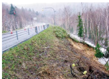
<①KP38.6表層崩壊箇所>
