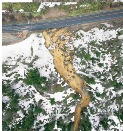
<④KP40.8表層崩壊箇所>
