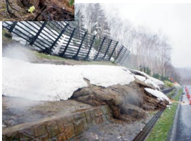
<②KP40.1表層崩壊箇所>
