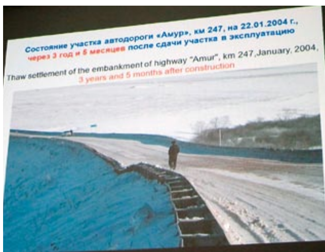
図-2 改築3年5ヶ月後の盛土の沈下例(自動車専用道路「アムール」)
