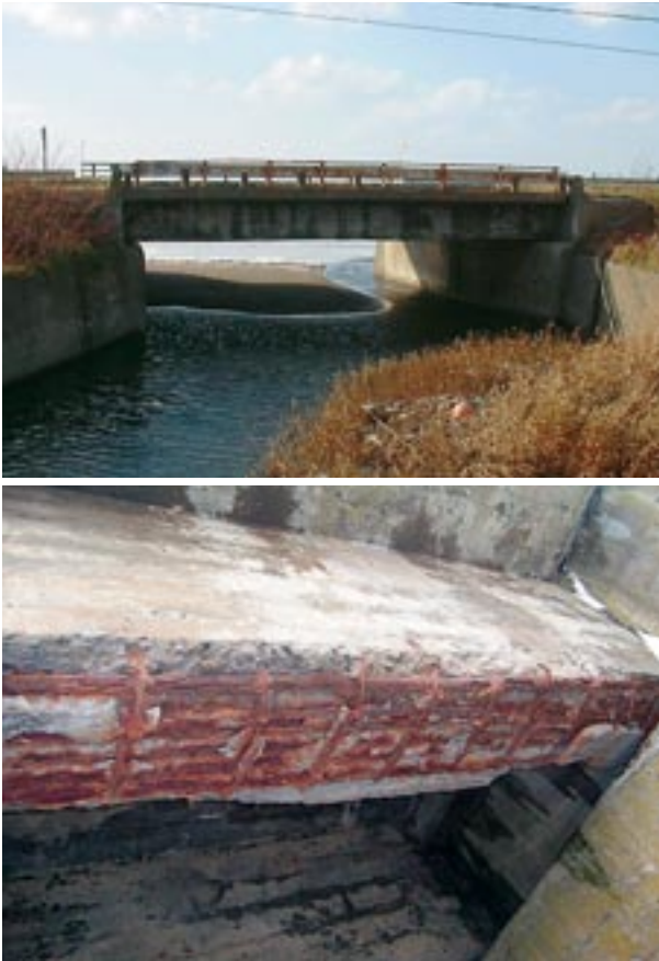
写真-5 塩害の損傷の例
