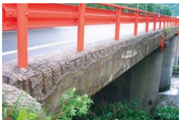
写真-4 凍害による地覆の損傷例
