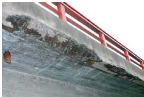
写真-3 凍害の損傷の例
