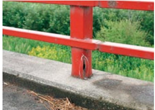
写真-6 防護柵の亀裂
