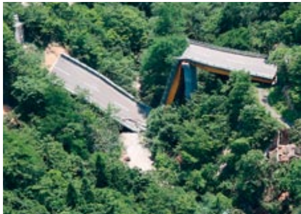
「平成20年岩手・宮城内陸地震」による道路被害 岩手県一関市 東北地方整備局提供
