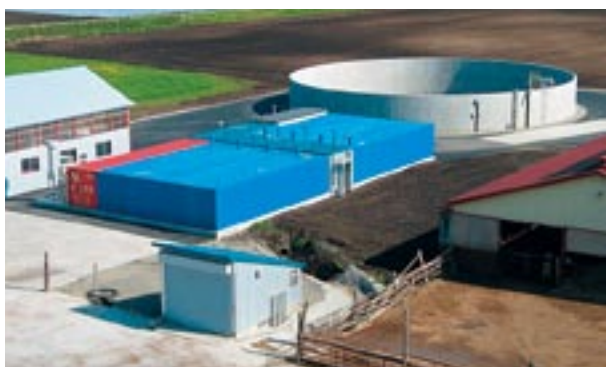
バイオガスプラント
