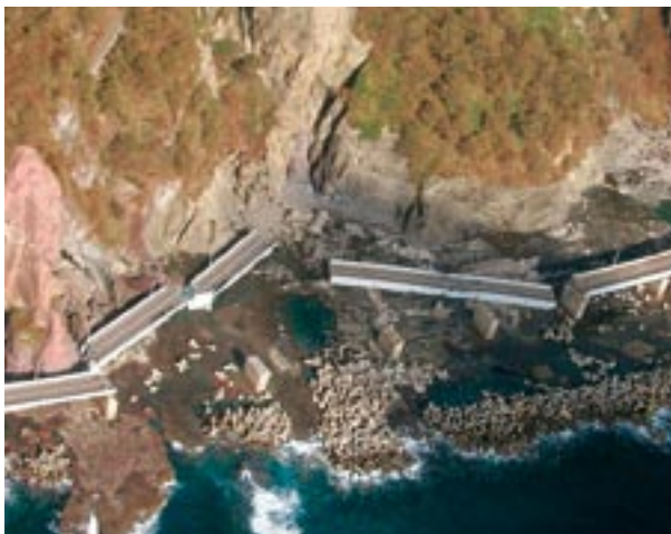
国道229号(平成16年9月の台風18号により大森大橋が落下)
