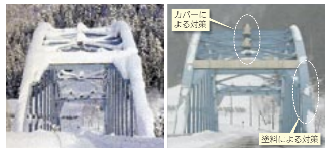
写真-1 橋梁の着雪状況
