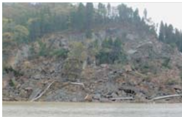
妙見白岩の県道(旧国道17号線)崩壊現場
