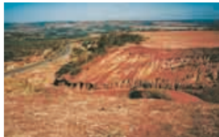
写真 - 12 雨水や道路排水による浸食
