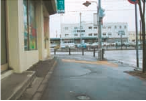
歩道の段差状況
