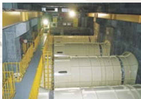
直径3,350 排風機・設置状況（換気所内）
