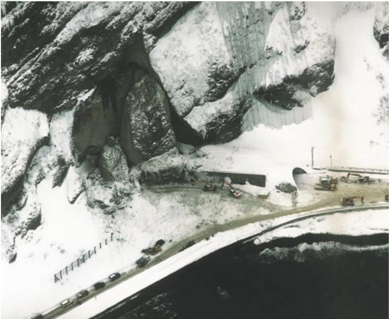
写真-1 豊浜トンネル崩落事故
