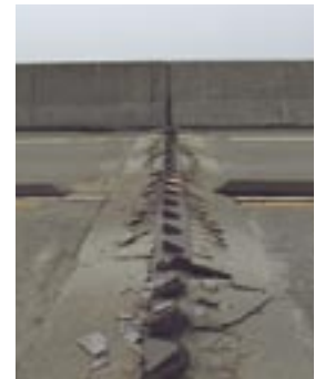
写真-7 泉の沢橋伸縮装置の損傷
