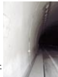
写真-11 洞爺トンネル覆工 継ぎ目の横ずれ
