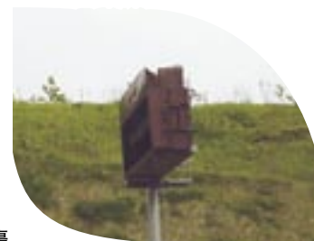
写真-13 情報板の損傷
