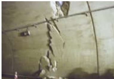
写真-10 洞爺トンネル覆工コンクリートの損傷
