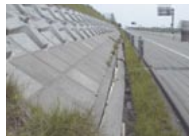
写真-12 切土のり面防護 ブロックの損傷
