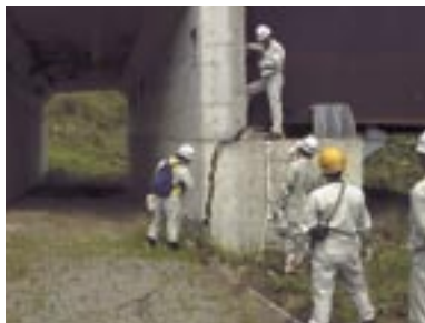
写真-8 板谷沢橋橋台の損傷
