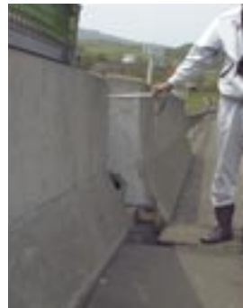
写真-6 虻田洞爺湖IC Eランプ橋上部工の横ずれ
