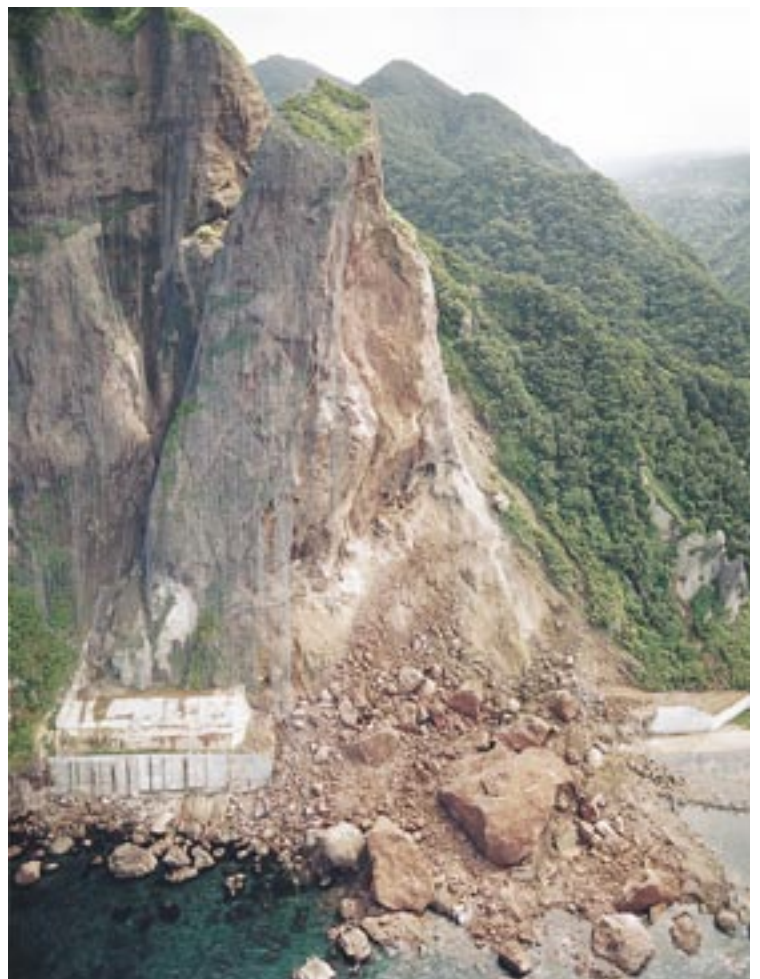
第2白糸トンネル崩落(平成9年8月)
