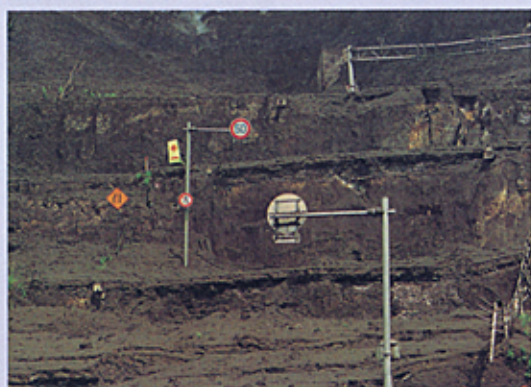
地盤変動で階段状になった一般国道230号虻田町泉地区 (7月21日有珠山土砂災害対策専門家チーム撮影)
