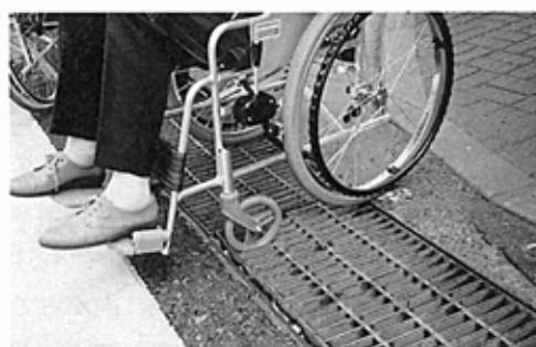
(写真-1) 通行の連続性が妨げられている例 (この状態では脱出困難)
