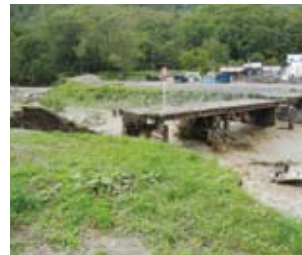
清田区有明(市有橋損壊)
