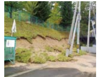
南区真駒内(緑地法面崩落)
